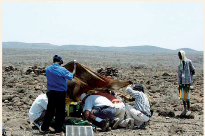
STATION DE DÉTECTION DES INFRASONS IS19 À DJIBOUTI (DJIBOUTI).
